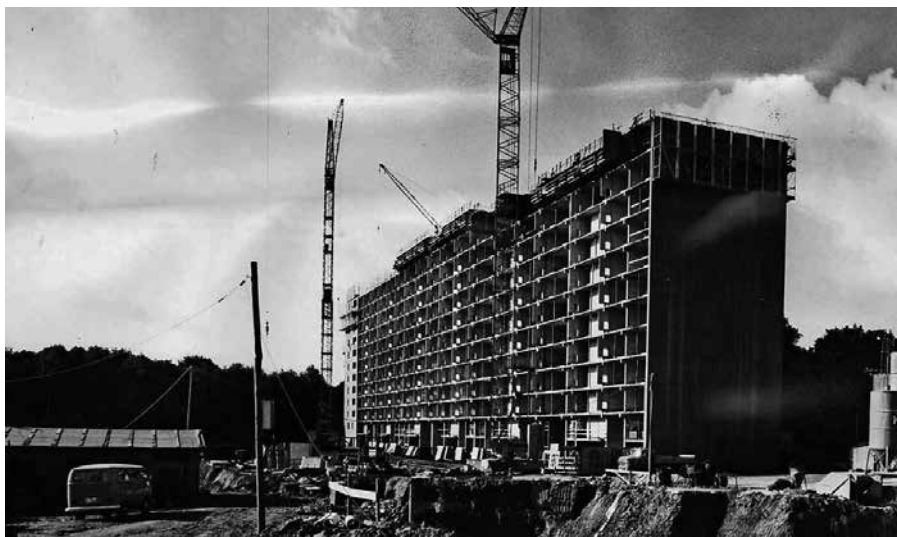
Gebäude B im Rohbau 1969. In einem Zeitraum von vier Jahren sind im Asemwald 1143 Wohnungen entstanden. Das Verhältnis von Wohnraum zu Flächenverbrauch kann als beispielhaft gelten.
