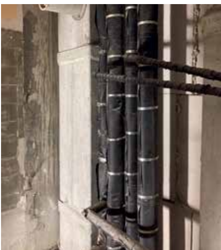
Bild 3: Steigleitungen Bad und WC
