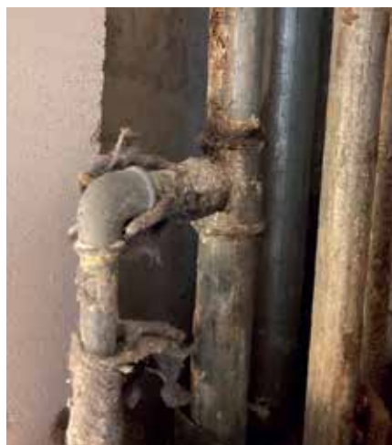
Bild 4: Schäden an Wasserleitungen
