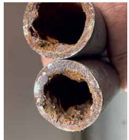
Bild 5: Ablagerungen in Trinkwasserleitung
